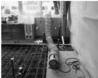
送風機設置状況
