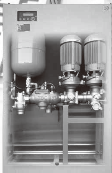
直結給水ブースタ ポンプユニット
