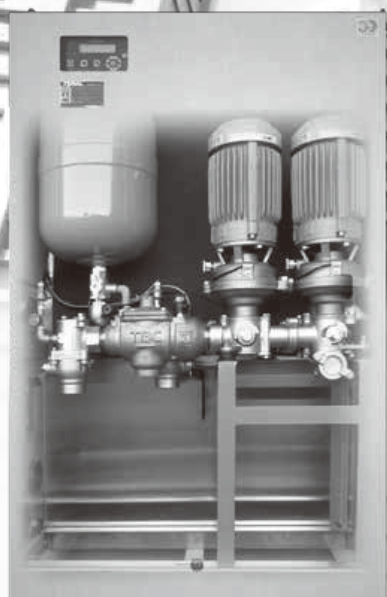
直結給水ブースタ ポンプユニット
