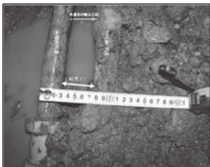
写真1 事故状況 (水道管とガス管の離隔距離4cm、埋設深さ双方とも0.85m)
