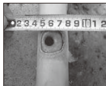
写真3 ガス管損傷箇所 (孔の大きさ:直径約10mm)
