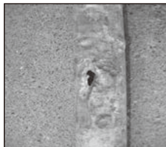
写真2 給水管漏水箇所 (孔の大きさ:5mm(最大)×15mm)
