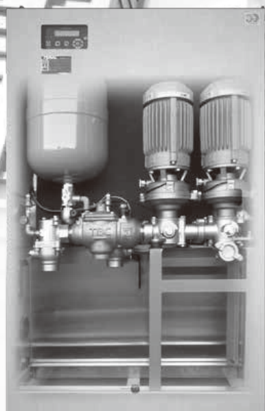
直結給水ブースタ ポンプユニット
